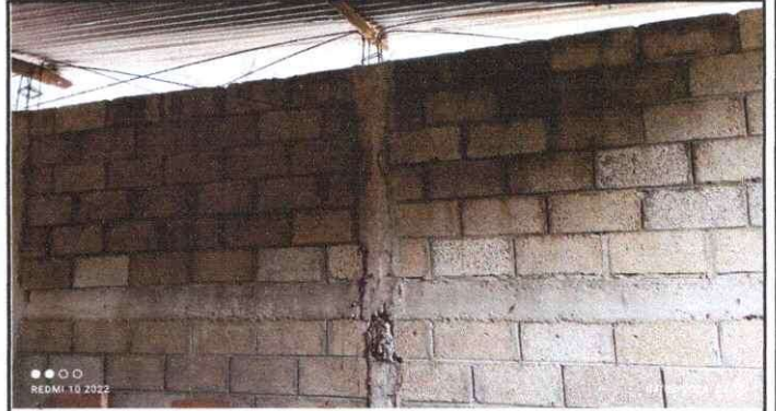
Foto 2: Se observa pared y columnas en mal estado necesita reforzar
