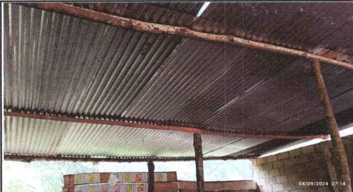
Foto 1: Se observa la estructura del techo en mal estado necesita ser sustituido por estructura metálica
