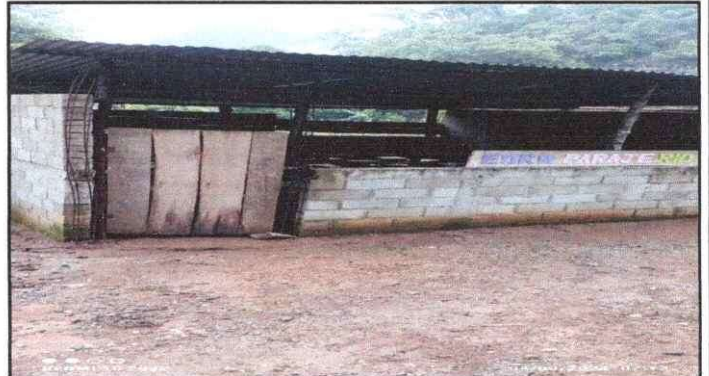
Foto 4: Se observa las puertas de madera y en mal estado se necesita sustituir
